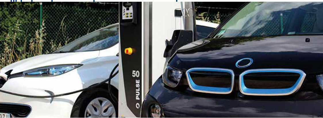
Une borne de recharge électrique rapide PULSE QC50 posée par SAG VIGILEC.
